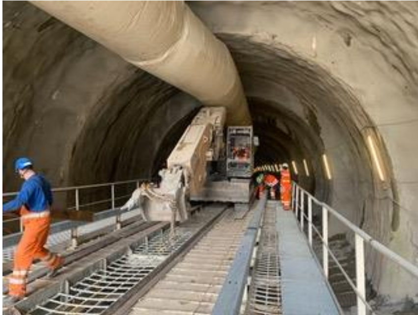
Pont de travail pour permettre la réalisation des radier et la poursuite des autres opérations dans le tunnel
